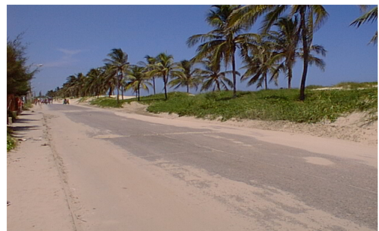
FIG. 13. Vía pavimentada en Boca Ciega en el lugar que debe ocupar la Duna.
